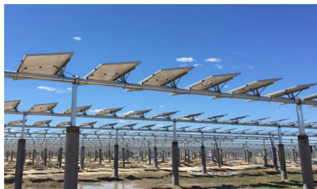
装机容量：100MWp 项目地点：吉林白城 产品类型：帷联跟踪系统
