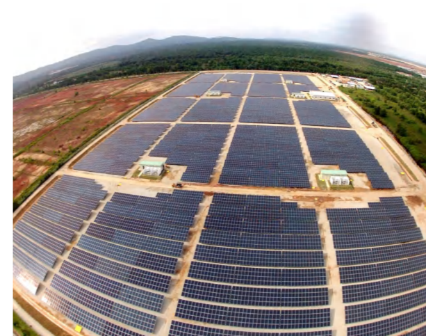
装机容量：100MWp 项目地点：马来西亚 产品类型：地面固定式光伏支架系统
