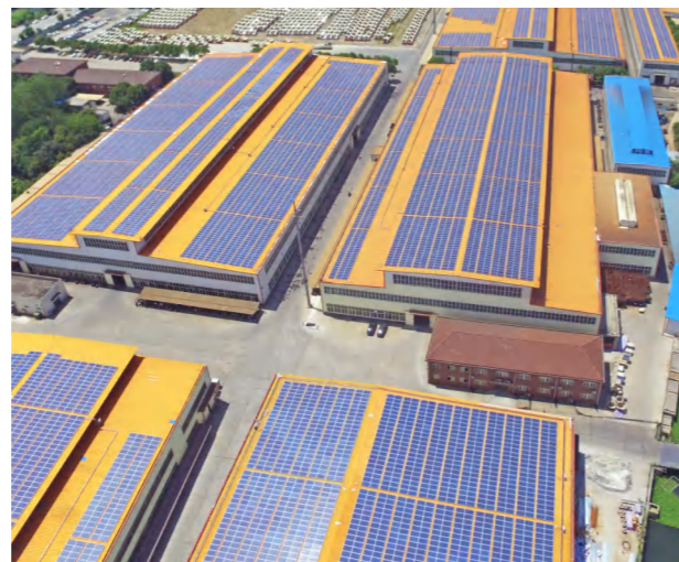
装机容量：21.5MWp 项目地点：江苏丹阳 产品类型：彩钢瓦屋顶系统
