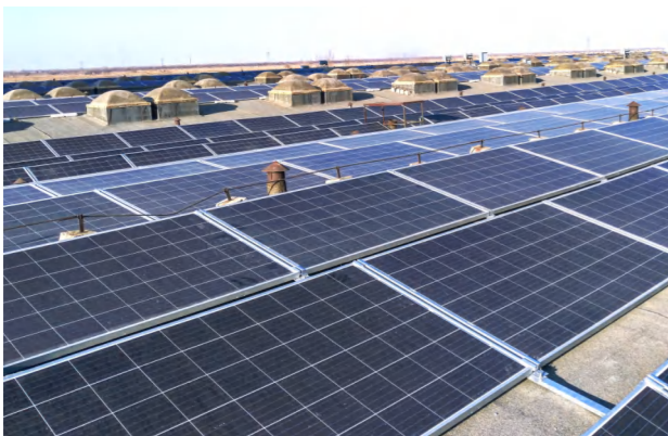
装机容量：3MWp 项目地点：河北沧州 产品类型：帷幄导流板屋顶系统
