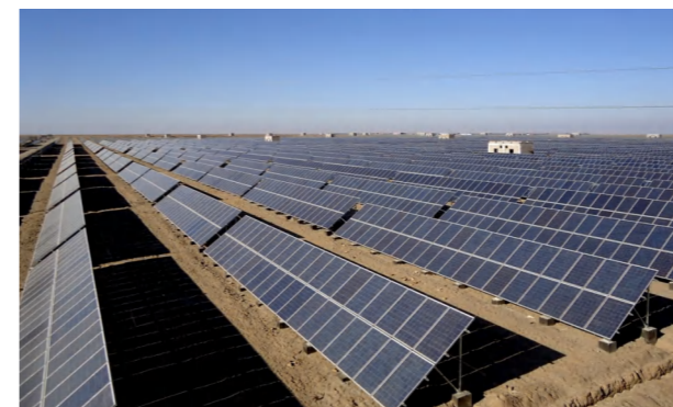
装机容量：200MWp 项目地点：甘肃敦煌 产品类型：地面固定式光伏支架系统
